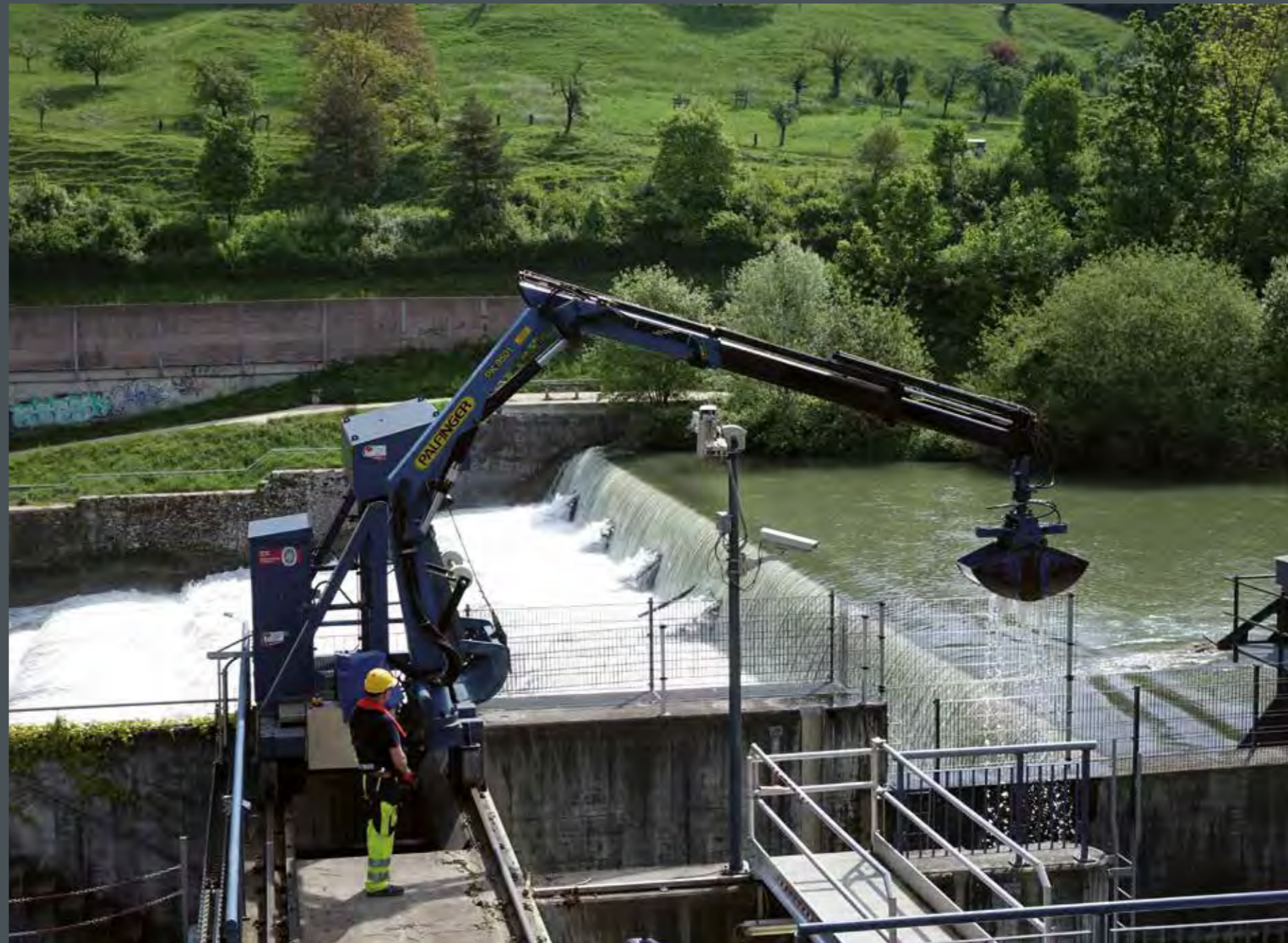
Der Wasser-Einlaufkanal muss regelmässig ausgebaggert werden.
